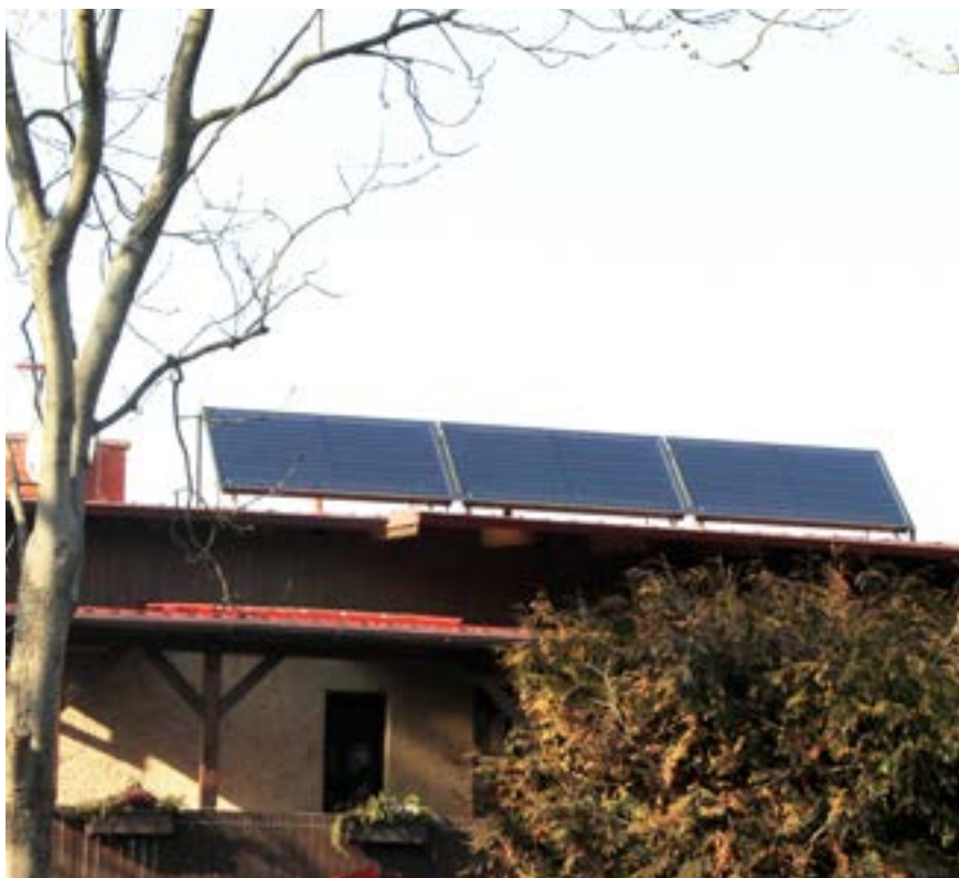
Tři vodorovné deskové kolektory Logasol SKS4.0-w s náplní inertního plynu argonu umístěné na ploché střeše domu
