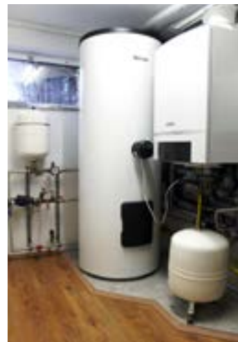
Technická místnost s kondenzačním kotlem Logamax plus GB162-25 a bivalentním zásobníkem Logalux SM400/5 E
